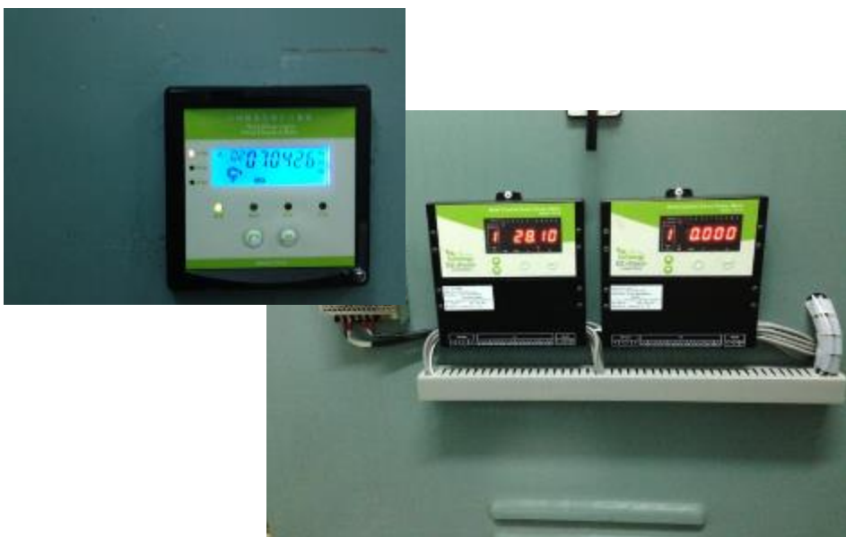
導入電能及需量監測管理系統
