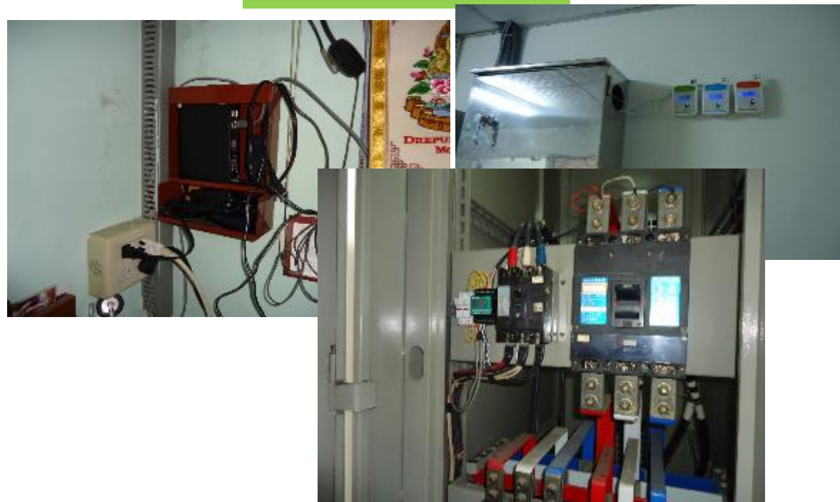
導入電能、需量、空氣品質監測管理系統
