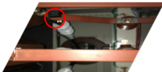
電纜與銅排銜接處溫度偵測
