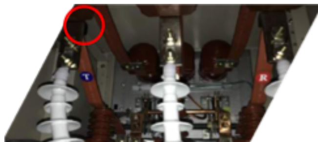
電纜與銅排銜接處溫度偵測
