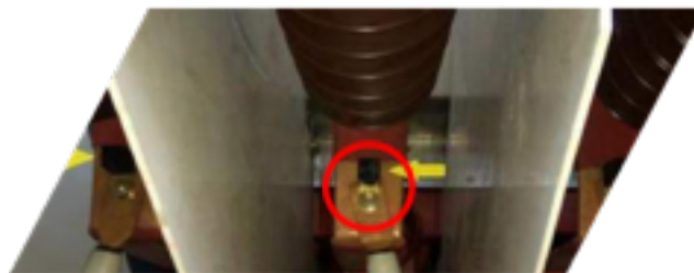
電纜與銅排銜接處 溫度偵測
